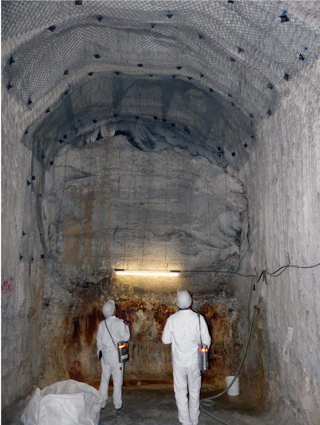
Foto 14: Pfeilerquerdehnung im Pfeiler zwischen Abbau 9/750 und ELK 8/750 (Pfeilerreihe 2/3); Aufnahme vom 19.05.2014
