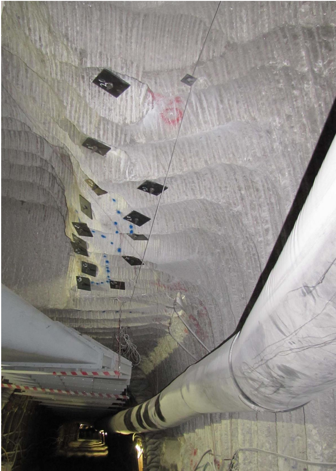
Foto 18: Mit blauen Punkten markierte Rissbildung und Firstsicherung im Pfeiler 2/3 auf der 725-m-Sohle; Aufnahme vom 26.08.2014
