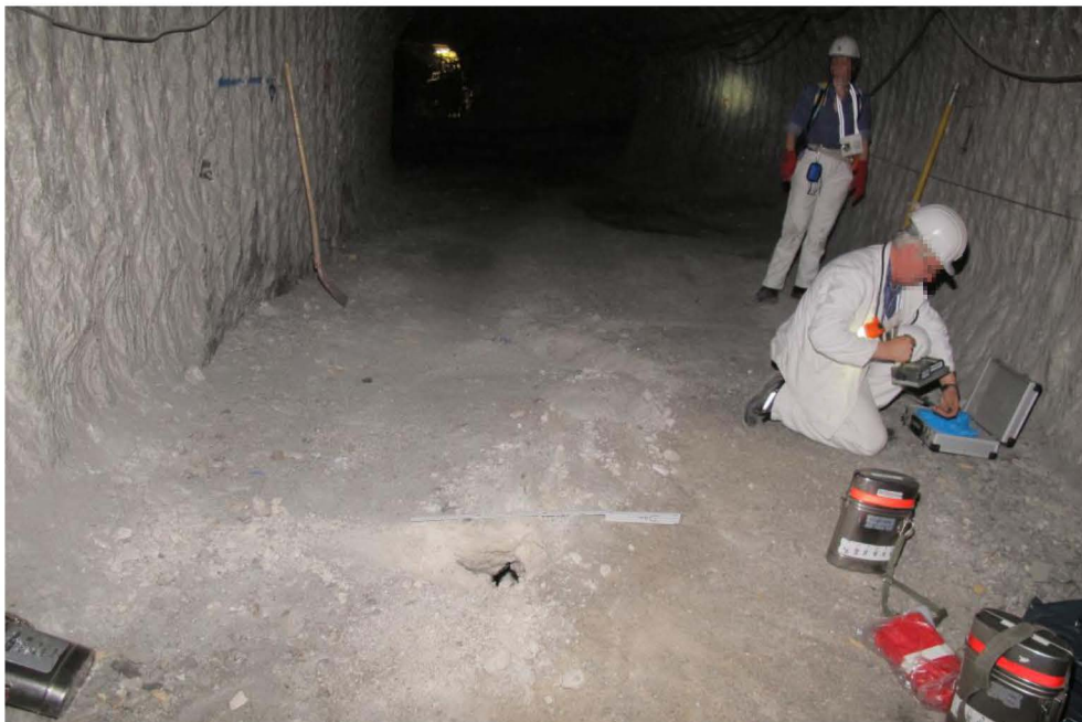
Foto 10: Sohlensaufwölbung vor ELK 4/750 mit angetroffener Lösung (Kataster-Code: P750144) vor der Sanierung; Aufnahme vom 19.06.2012
