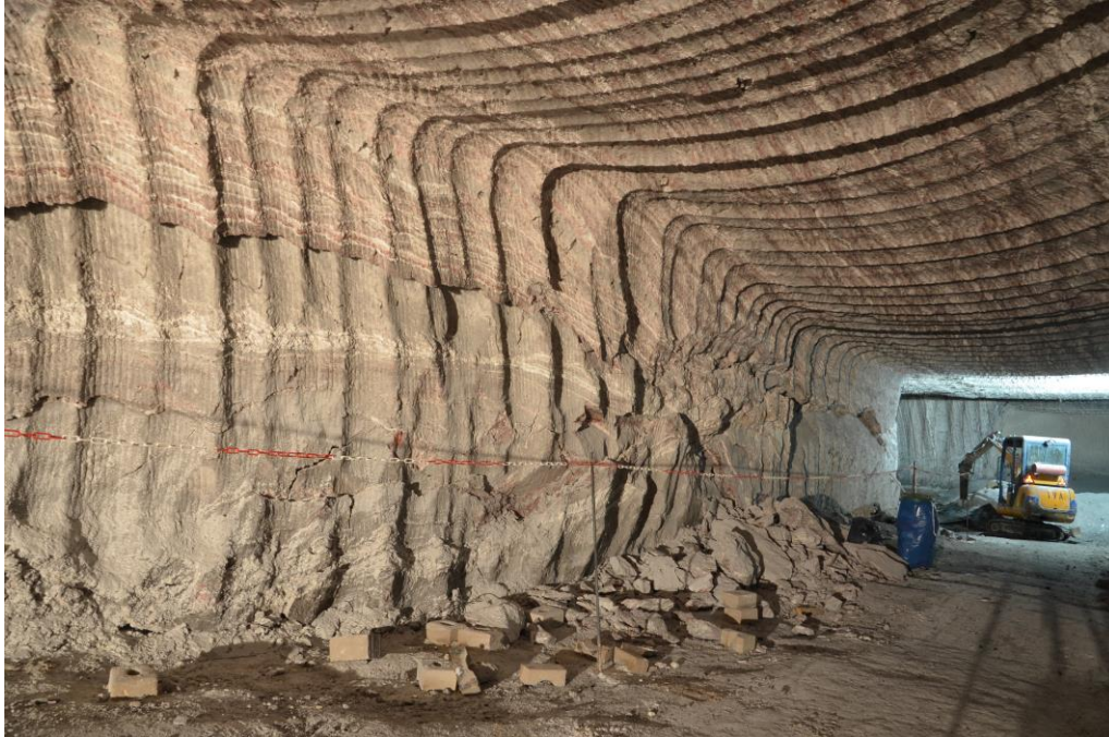
Foto 1: Umfahrung von Blindschacht 2, 750-m-Sohle, intensive geschädigter Süd-Stoß; Aufnahme vom 22.05.2014
