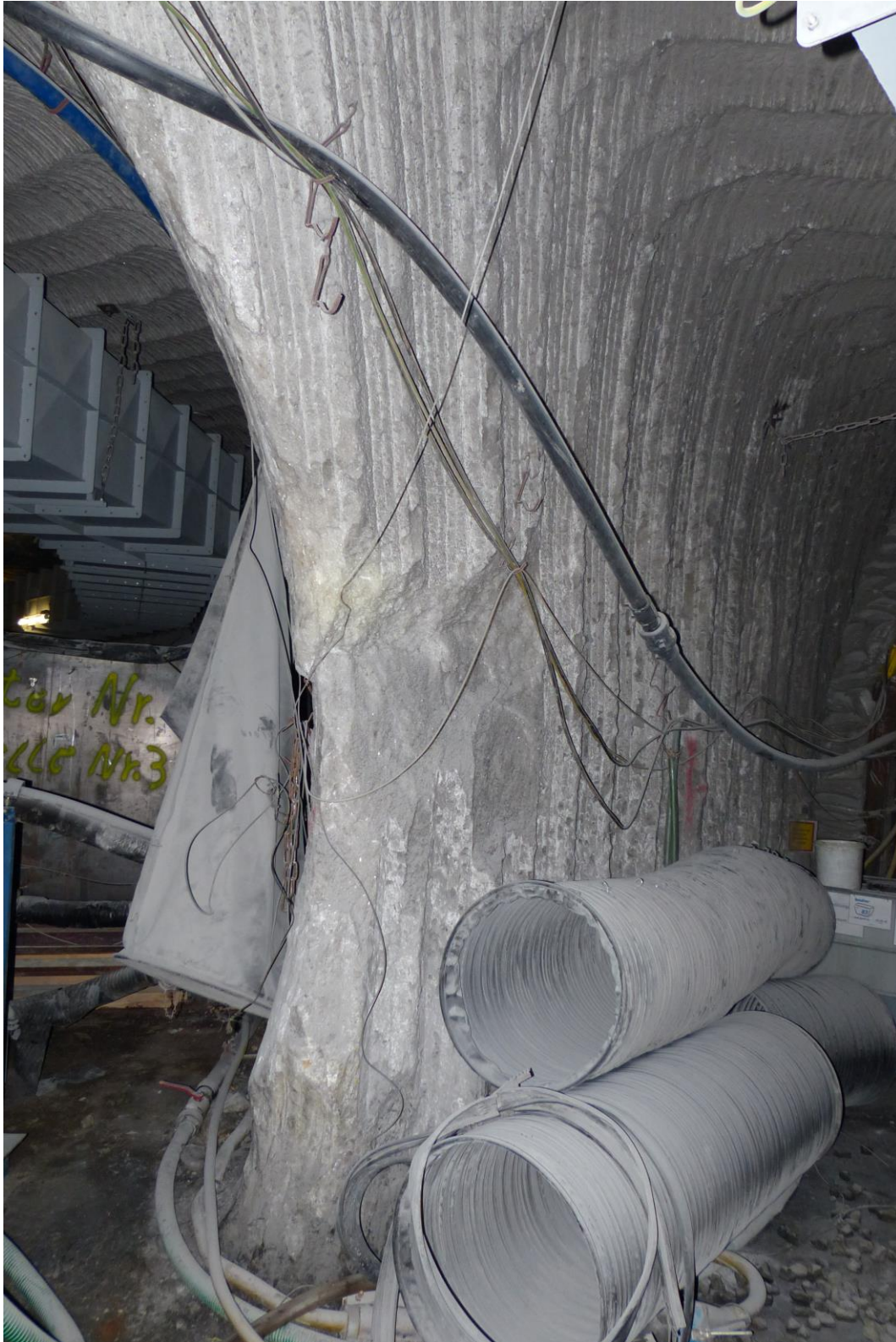
Foto 17: Abgescherter Pfeiler – ausbildung eines Doppelkegels („Sanduhr“) – zwischen dem Querschlag nach Norden und der Richtstrecke nach Westenauf der 725-m-Sohle in Richtung Blindschacht 2; Aufnahme vom 04.09.2014
