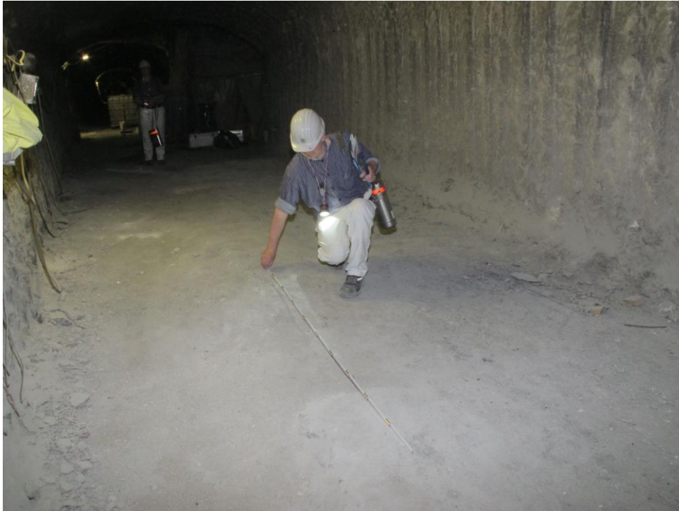
Foto 11: Sohlenaufwölbung im Bereich zwischen der ELK 4/750 und ELK 8/750; Aufnahme vom 21.03.2014
