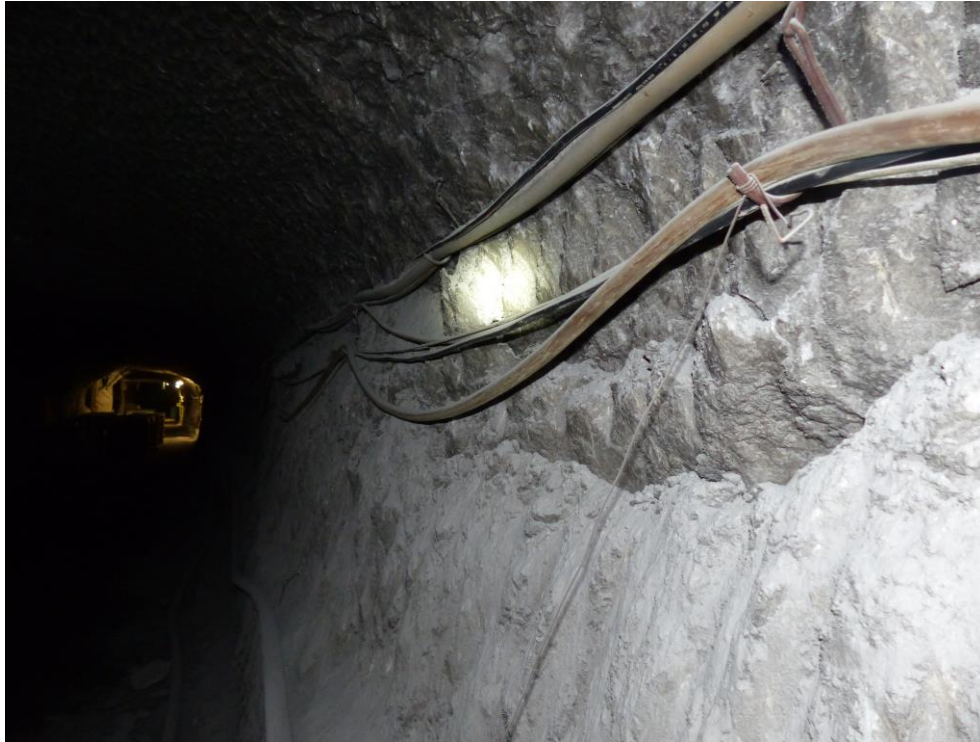
Foto 5: Geschädigter Südstoß, 2. südliche Richtstrecke nach Westen, Bereich vor ELK 8/750; Aufnahme vom 19.05.2014
