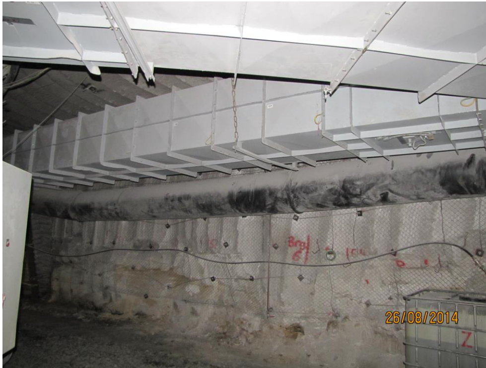
Foto 15: Risse im Pfeiler 3/4 auf der 725-m-Sohle, Aufnahme vom 26.08.2014
