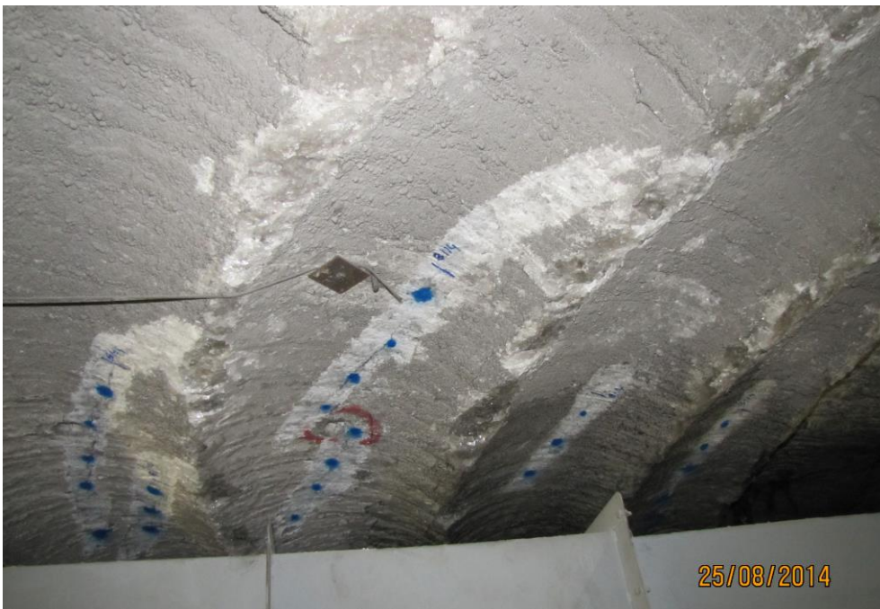
Foto 16: Risse in der Firne oberhalb der „Radonlutte“, Richtstrecke nach Westen auf der 725-m-Sohle, Aufnahme vom 25.08.2014
